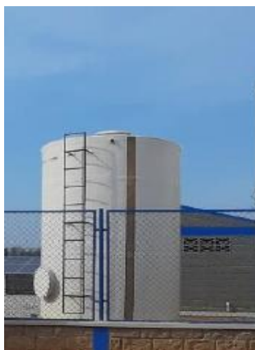
Ilustración 5. Tanques de almacenamiento – Sistema Acceso Agua – Jurura – Uribia
