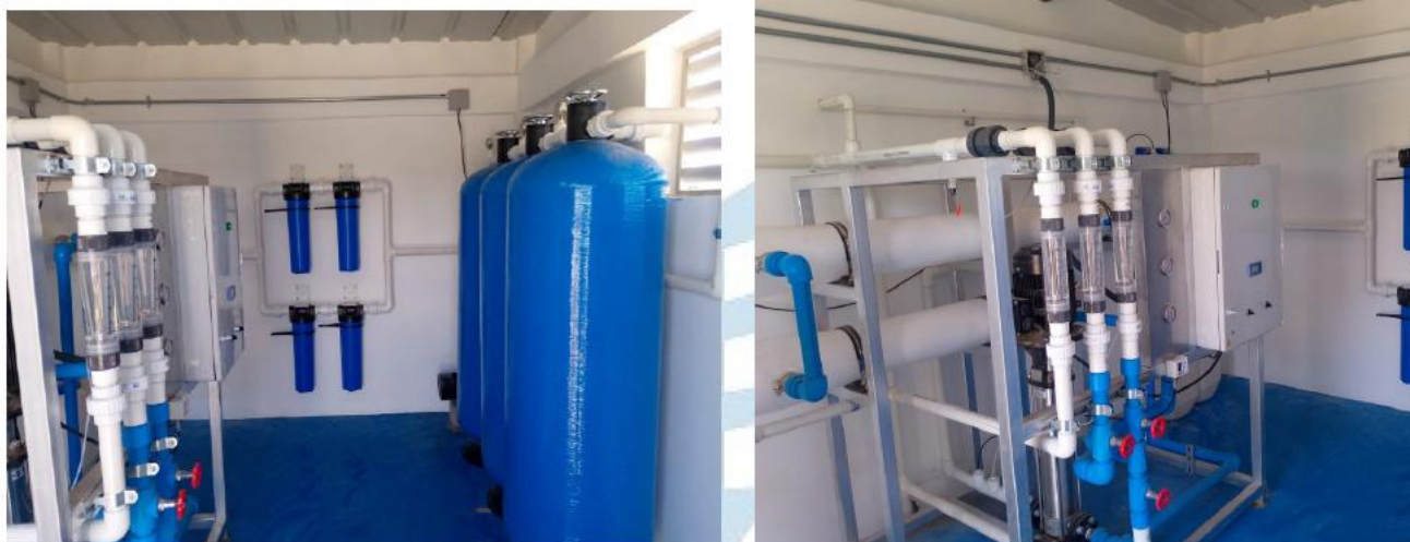
Ilustración 6. Equipos para el tratamiento – Sistema Acceso Agua - Jurura – Uribia
