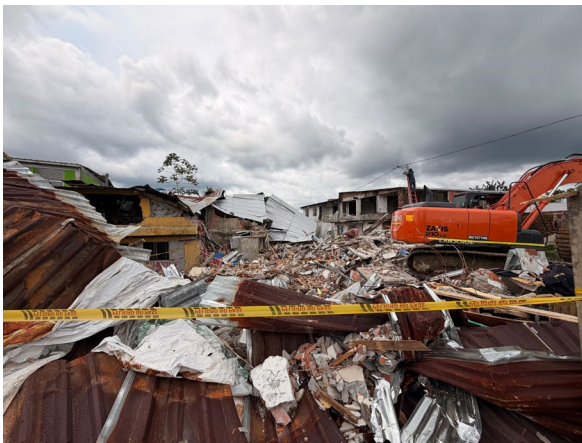
Vivienda afectada por la emergencia Choc6, Uni6n Panamericana— 15 de agosto de 2026.
