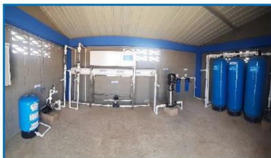
Ilustración 7. Equipos para el tratamiento – Sistema Acceso Agua - Pasipamana – Maicao
