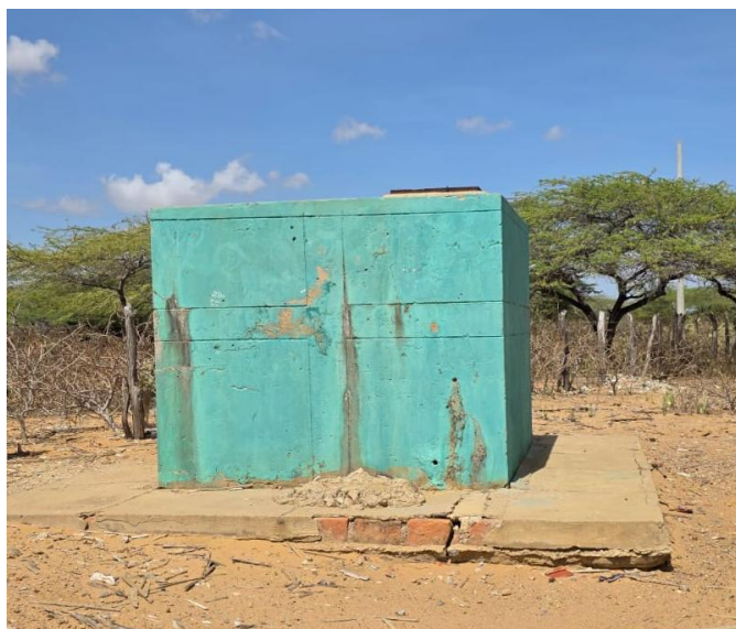
Alberca de almacenamiento de agua en sede Pasipamana, en estado de deterioro estructural y pérdida de impermeabilización
