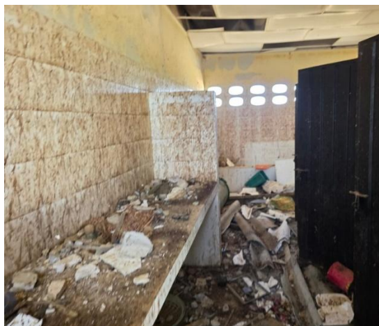
Estado de la Batería sanitaria, con acumulación de basura y escombros. Evidencia para la actividad de limpieza y desinfección, incluyendo retiro de residuos y disposición en sitio autorizado.
