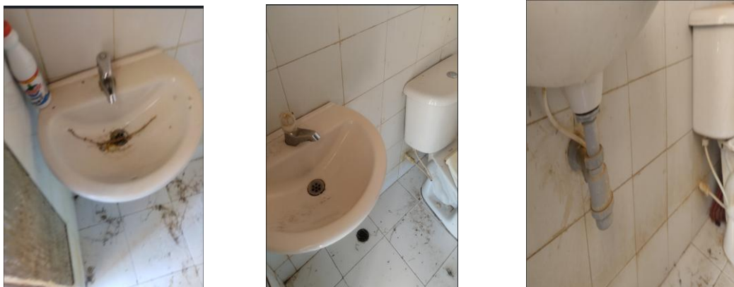
Ilustración 5. Condiciones de griferías y conexiones en lavamanos.
