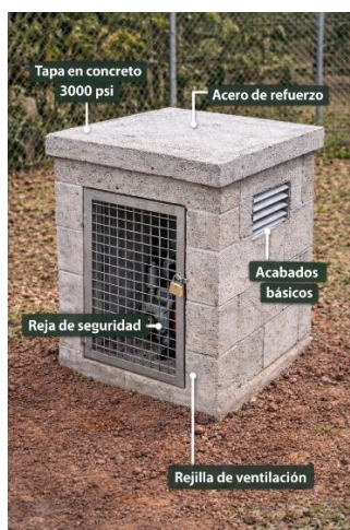
Ilustración 18. La imagen muestra una estructura en bloque de concreto con tapa reforzada, rejillas de ventilación y acabados básicos, evidenciando el diseño destinado a proteger la motobomba
