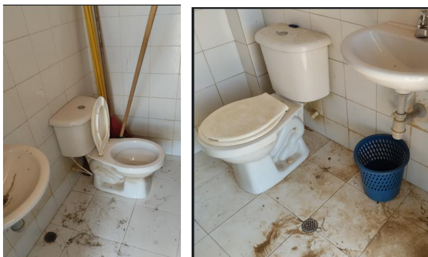
Ilustración 4. La imagen muestra un sanitario instalado en un baño escolar, evidenciando el estado actual de uso y desgaste
