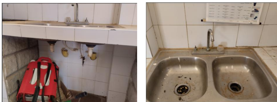
Ilustración 6. La imagen muestra el área inferior y condiciones de un lavaplatos con tuberías, accesorios y griferías visiblemente en estado de desgaste.
