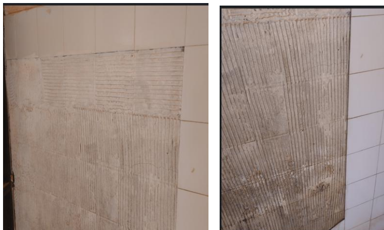
Ilustración 8. La imagen muestra un muro con revestimiento cerámico parcialmente retirado, evidenciando el estado de deterioro y la preparación de superficie para nueva instalación.
