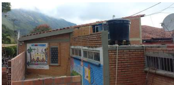
Imagen 5. Referencia sistema de almacenamiento.
