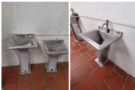
Imagen 4. Imagen de referencia e instalación de bebedero.
