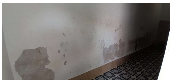
Imagen 6. Imagen de estado actual del muro a intervenir.
