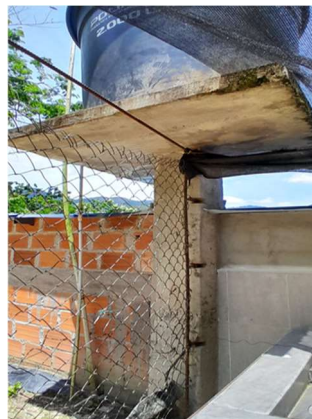
Imagen 2. Red hidráulica existente (Salida de tanque de almacenamiento)
