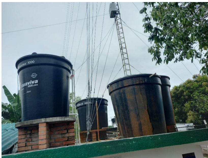
Imagen 11. Tanques de almacenamiento existentes para conectar
