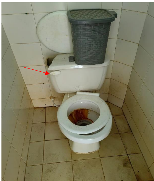
Imagen 17. Sanitarios instalados con sistema de descarga por palanca
