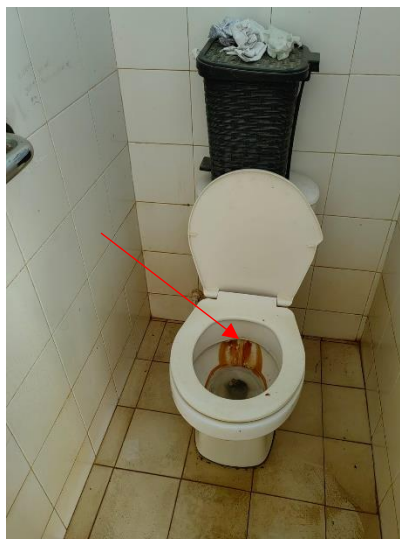
Imagen 31. Manchas en los sanitarios de la batería
