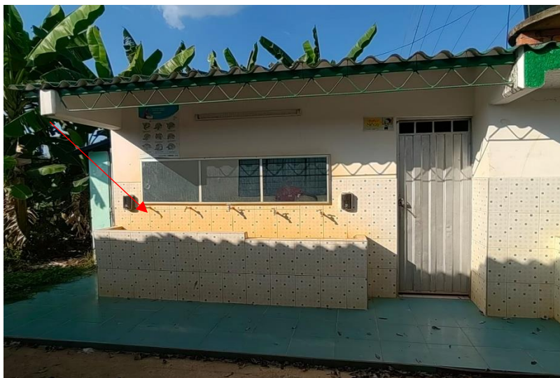
Imagen 28. Manchas en el enchape de muro de la batería sanitaria
