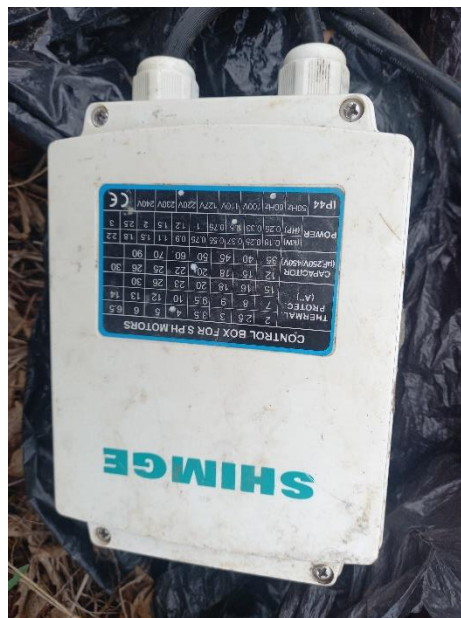
Imagen 18. Tablero eléctrico existente
