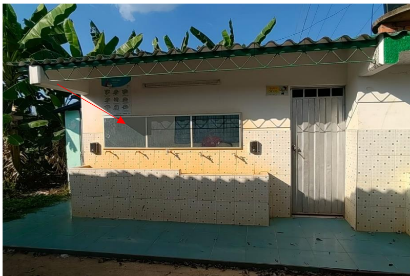
Imagen 30. Manchas en el espejo de la batería sanitaria
