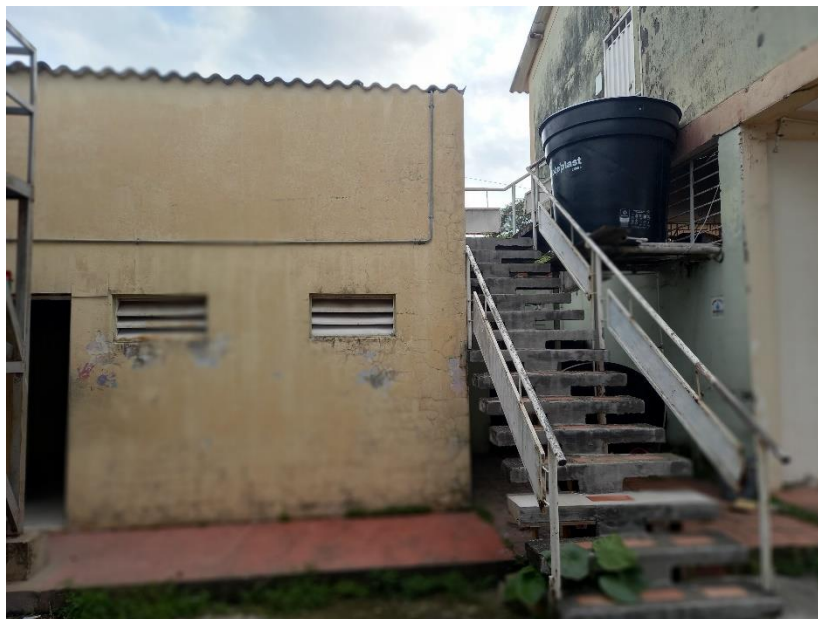
Imagen 16. Tanques de almacenamiento existentes para conectar
