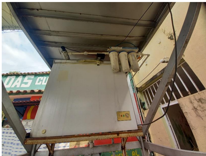
Imagen 36. Vista de los enfriadores para mantenimiento y limpieza
