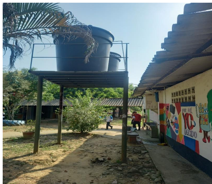
Imagen 30. Estructura de soporte tanques batería sanitaria bloques
