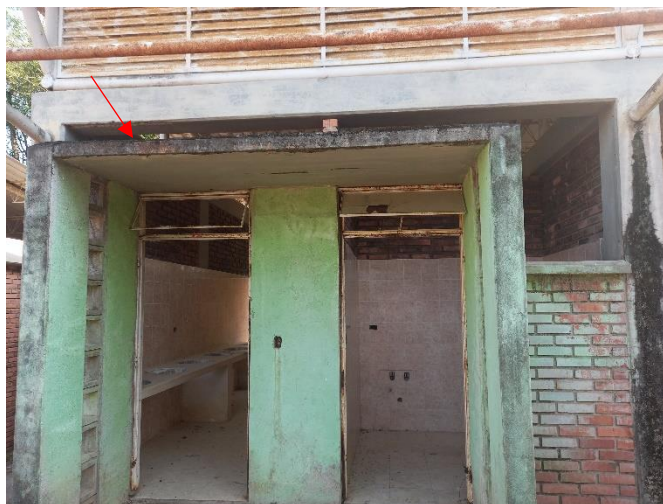
Imagen 21. Placa existente para impermeabilizar
